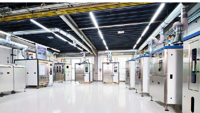
Technikum der kolb Cleaning Technology GmbH in Willich
